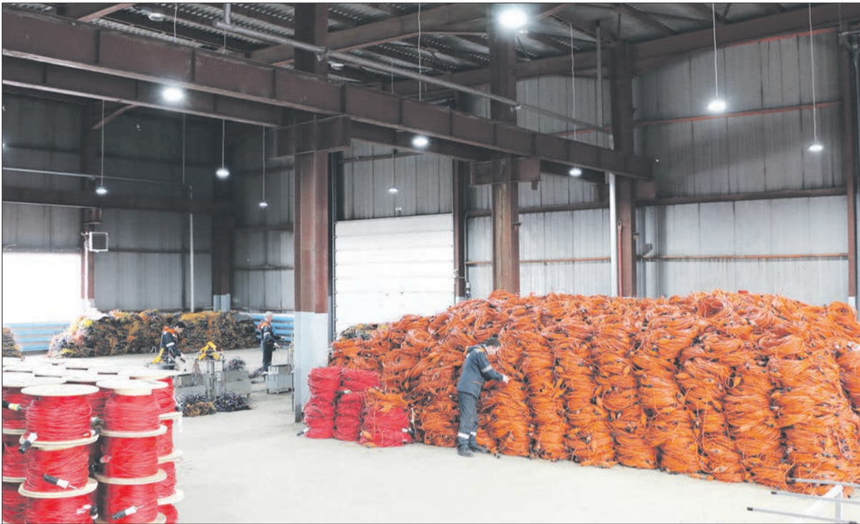
Новое освещение в боксе по сортировке оборудования управления «Геосервис»
